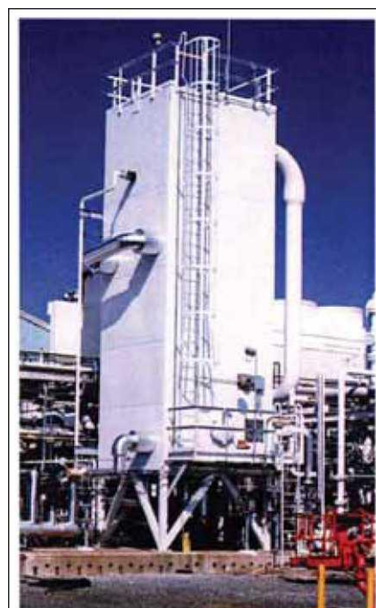
Низкотемпературный блок ожижения СПГ
