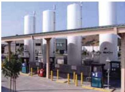
Крупнейшая в мире станция СПГ/сжатый газ, построенная Chart NexGen в Калифорнии 4 x 60 000 литров объемом, 6 СПГ заправочных колонок, 3 заправочных колонки сжатого газа, обслуживающая 200 мусоровозов
